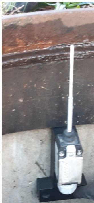
Zdjęcie nr. 4 Nieprawidłowy montaż
